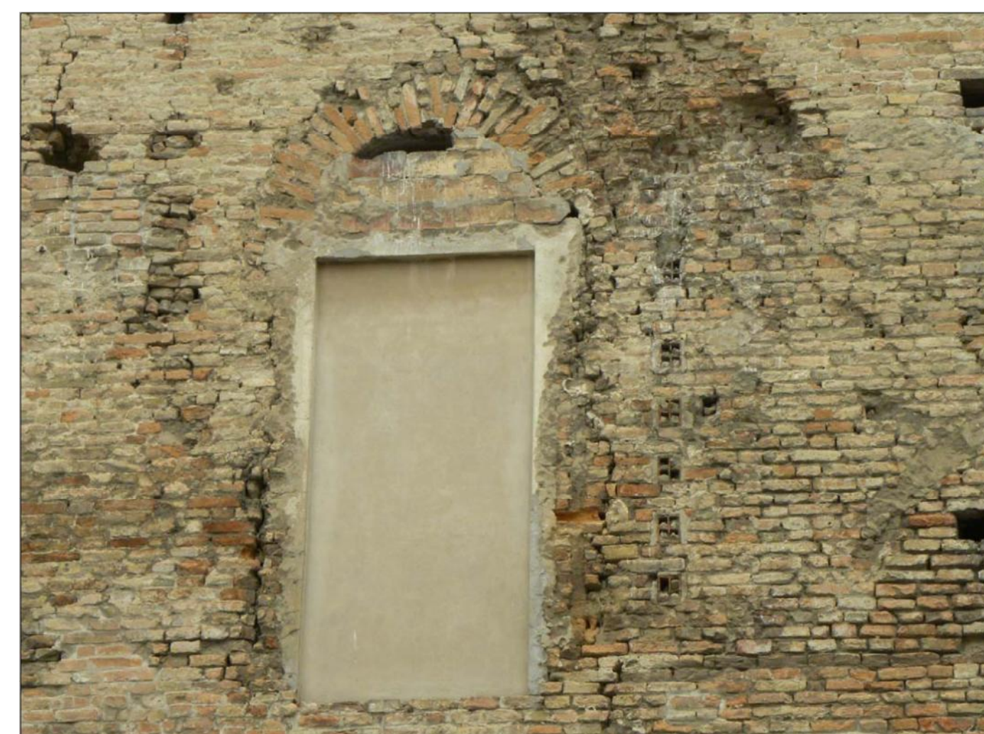
FOTO 2 - APERTURA ESISTENTE TAMPONATA
