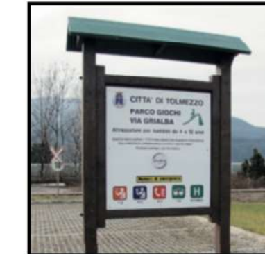
Fornitura e posa in opera di tabella informativa cm. 125x125 su pali di ferro tubolare, compreso getto per fondazione.
