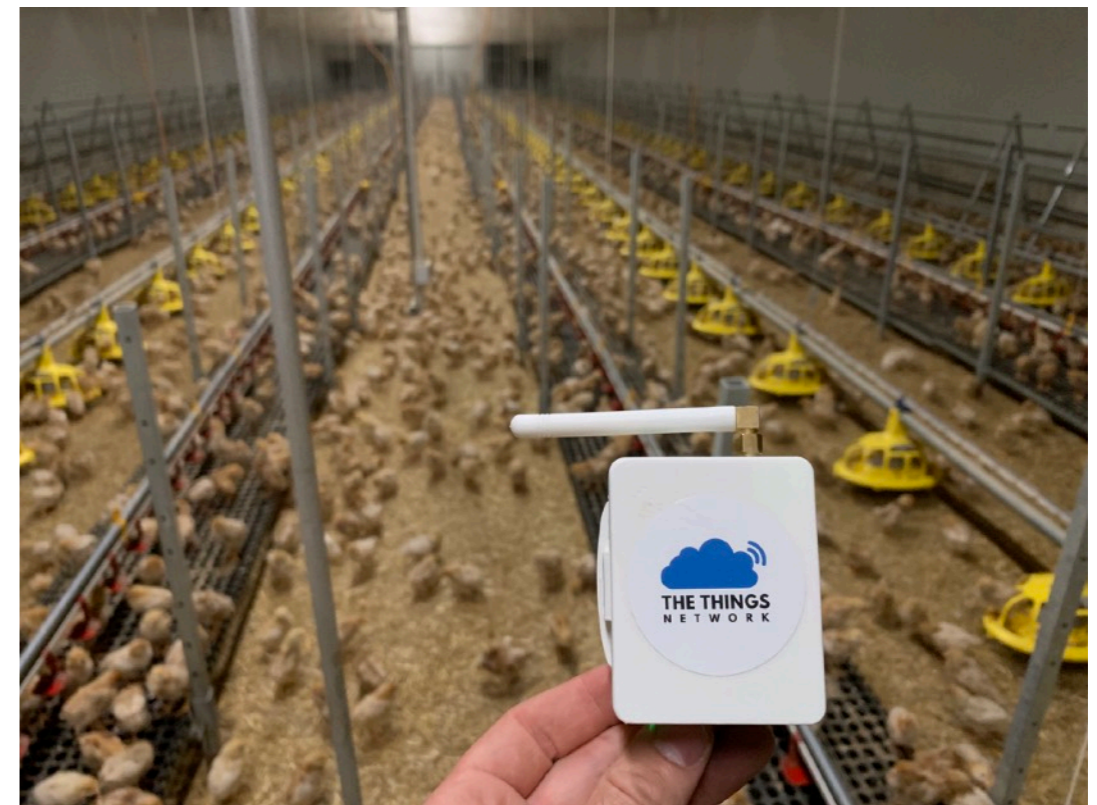
Sensore di temperatura ed umidità connesso tramite LoRaWan su piattaforma TTN
